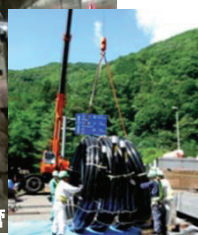
WEETAパイプ/トンネル消火栓用本管
