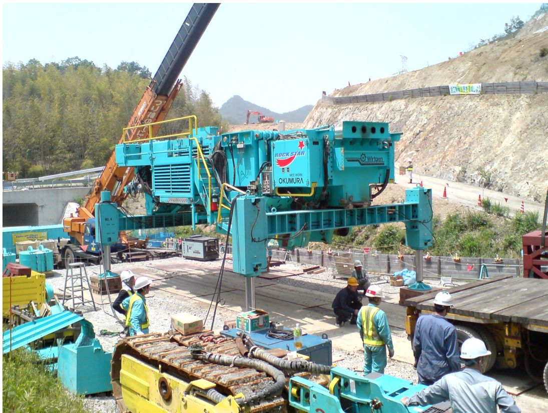
本体吊上げ装置（SMLU装置）を使用している組立解体状況
