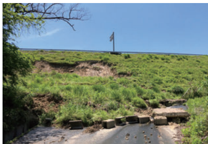
令和5年5月豪雨災害 写真は西日本高速道路(株)様より提供
