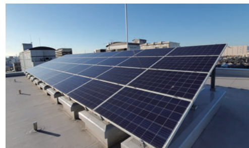
太陽光発電パネル設置状況
