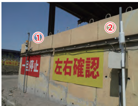
残土・コンクリートガラ集積場入口部に設置したセンサー①②
