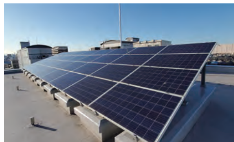
太陽光発電パネル設置状況
