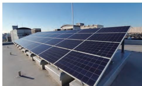
太陽光発電パネル設置状況
