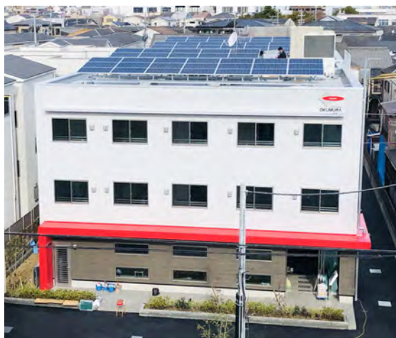
塚口宝来寮 太陽電池パネル設置状況
