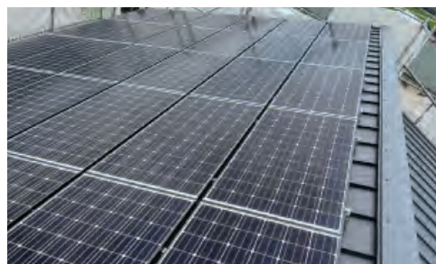
太陽光発電パネル設置状況
